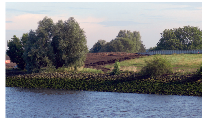
Der Deich im Werderland wird größtenteils in einen Erddeich umgebaut. Die Spundwand wird entfernt.
